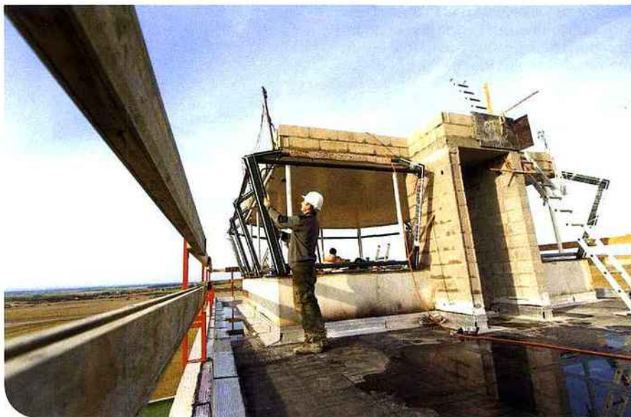
La tour de contrôle est en cours de rénovation sur la base de Chambley.
